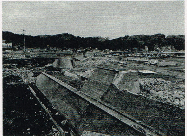
写真-1 破壊された宮古市田老の防潮堤
