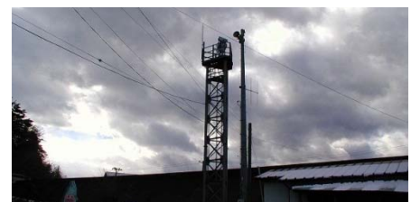
【写真-10】 津波監視カメラ
