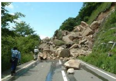
【写真-14】 2008年岩手・宮城内陸地震時の被災状況
