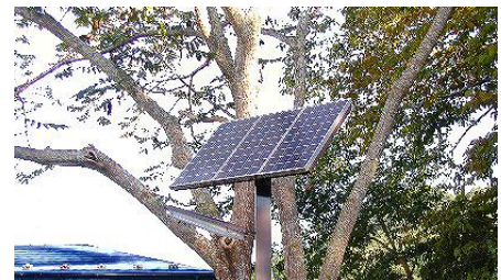
【写真-09】 ソーラー式避難誘導灯
