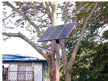
【写真-10】 ソーラ式避難誘導灯
