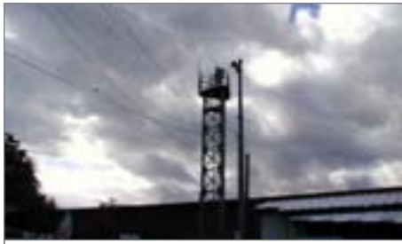
【写真-09】 [4枚] 津波監視カメラ
