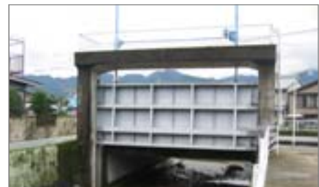
【写真-08】[9枚] 横引ゲート、水門、防波堤
